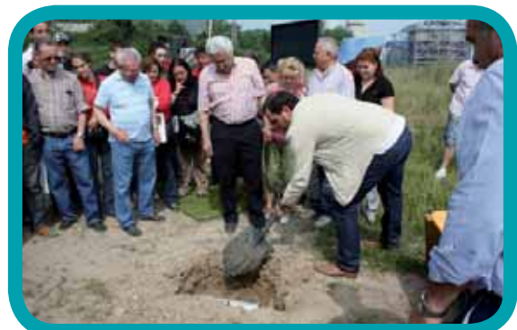
El 3 de junio se realizó el acto simbólico de colocación de la primera piedra del nuevo campo de fútbol.
